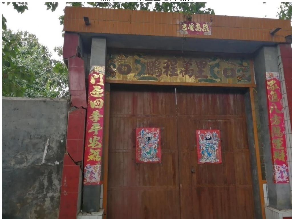
照片 6-4 受地面塌陷影响的房屋开裂
