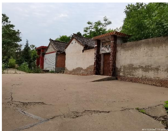
照片 6-4 塌陷村庄现状
