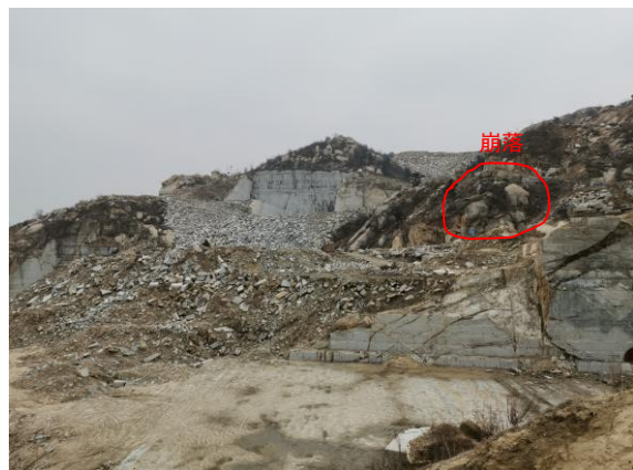
照片 5-2 高陡边坡坡脚崩塌堆积体
