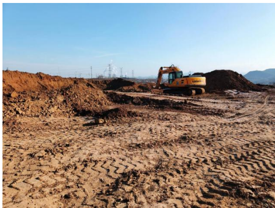
照片 6-2-1 1 号塌陷区治理情况
