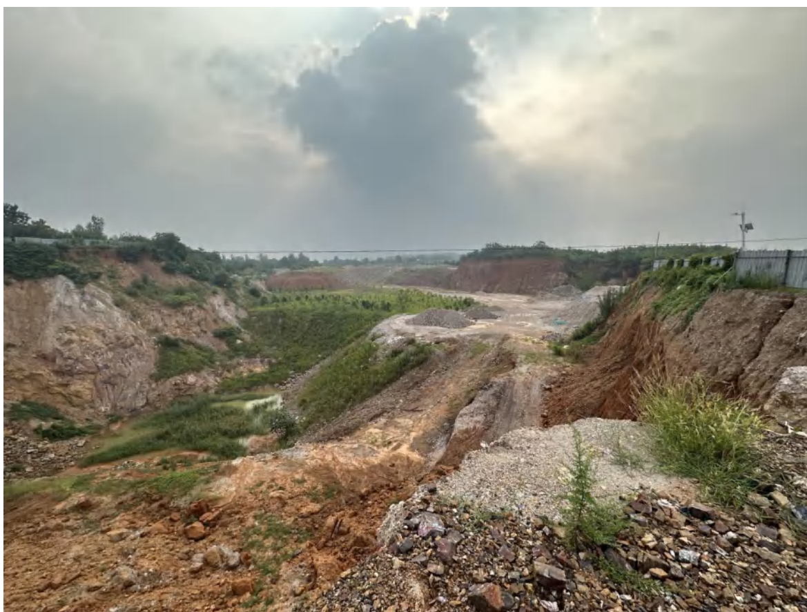
照片 6-10 已治理 6#损毁区现状（工程尚未完全结束）
