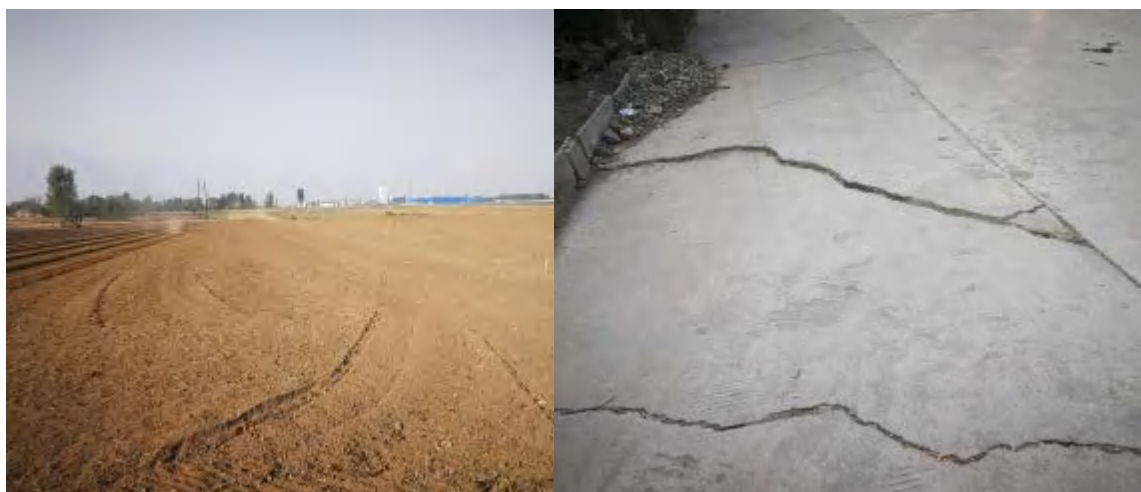
图 5-3 现状地表塌陷点
