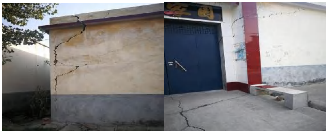
图5-2 赵屯村房屋贯穿性裂缝
